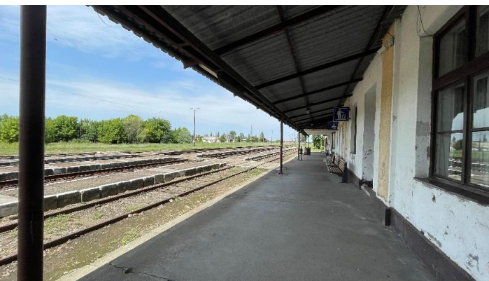
Fig. 26_stânga sus_ Peron Gara Salonta- Vedere spre zona industrială dezafectată din str. Ghestului
