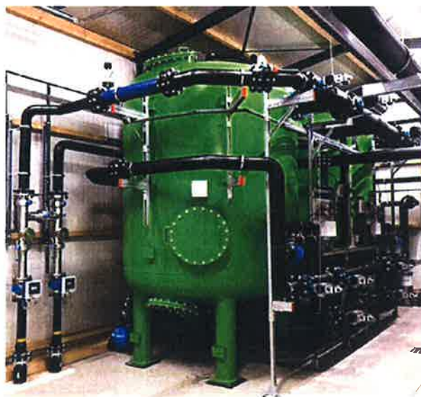
Fig 5: 3 unități de filtrare legate paralel
