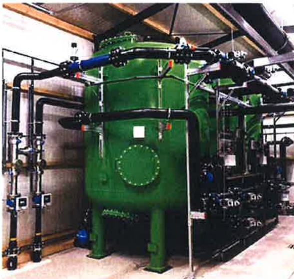
Fig 5: 3 unități de filtrare legate paralel
